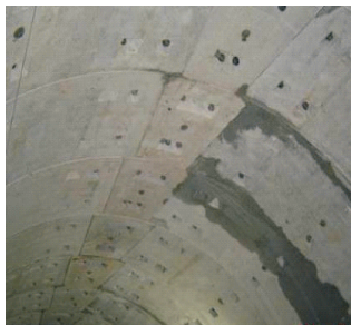
图8.1 盾构隧道渗漏
