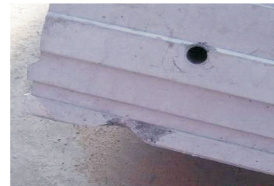
图9.3 管片安装前破损
