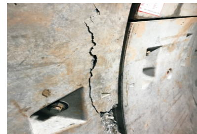
图9.4 管片安装后破损
