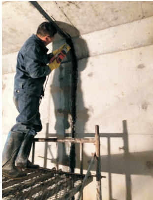
图7.1 管廊拼缝渗漏
