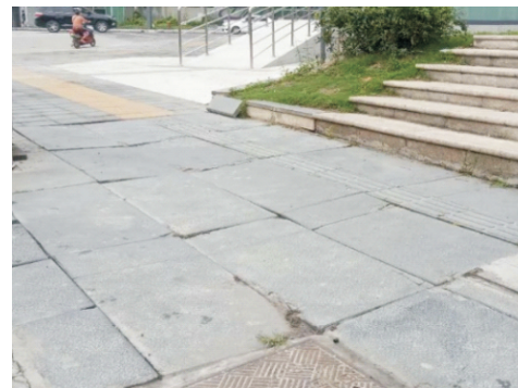
图3.1~2 人行道铺装松动、沉陷
