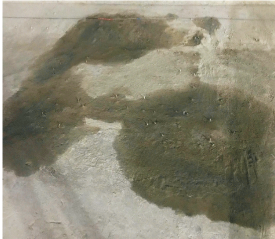
图8.8 矿山法隧道渗漏
