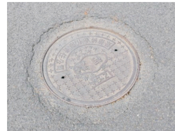
图1.1 检查井与路面衔接不平顺
