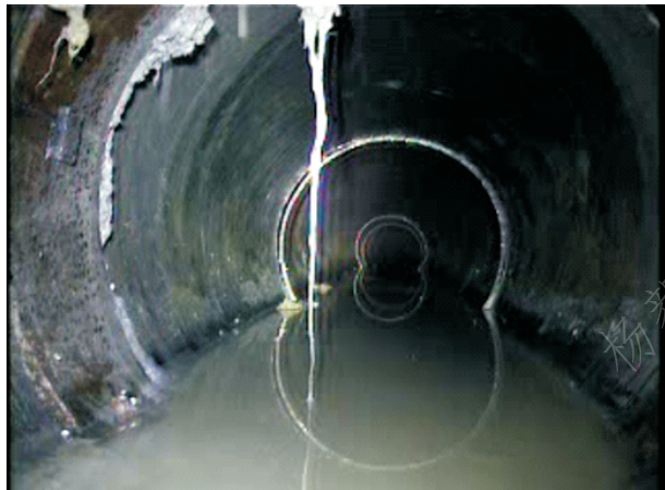
图4.1 排水管道渗漏
