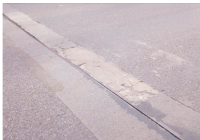
图6.1 伸缩缝保护带混凝土破损
