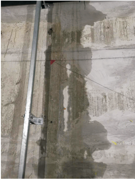
图8.4 地铁明挖车站结构渗漏
