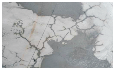
图2.19 装配式叠合板板面开裂
