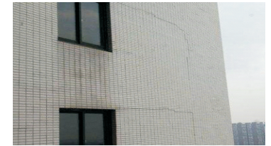
图4.2 外墙饰面砖开裂图
