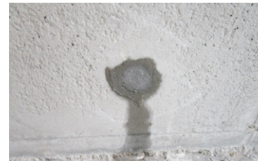
图4.5 拉杆洞渗漏图
