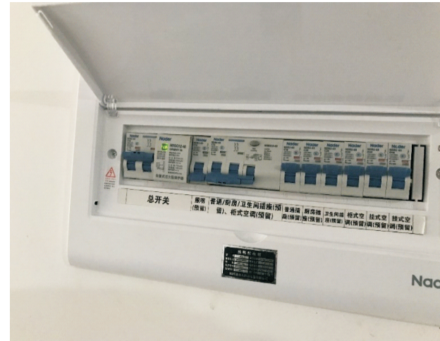
图6.9 户内配电箱回路齐全，标识正确
