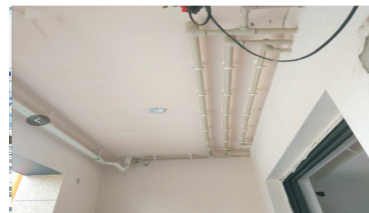
图9.1 户内明敷给水管道未保温
