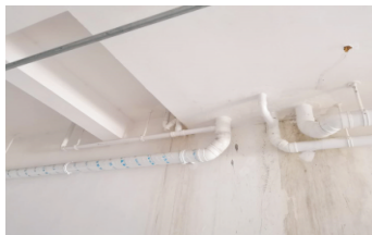
图8.1 排水支管接点不满足8.1.1要求
