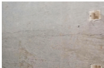
图2.20 装配式叠合板板底开裂
