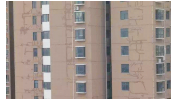
图4.1 外墙涂料饰面层开裂图
