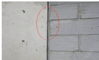
图3.1 不同材料间开裂
