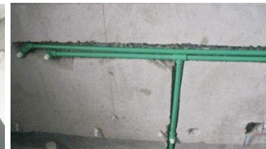
图9.2 墙面水平开槽过长
