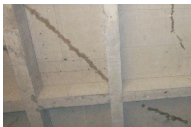
图2.2现浇板板底开裂
