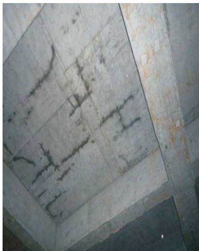
图1.6 地下室顶板开裂渗水
