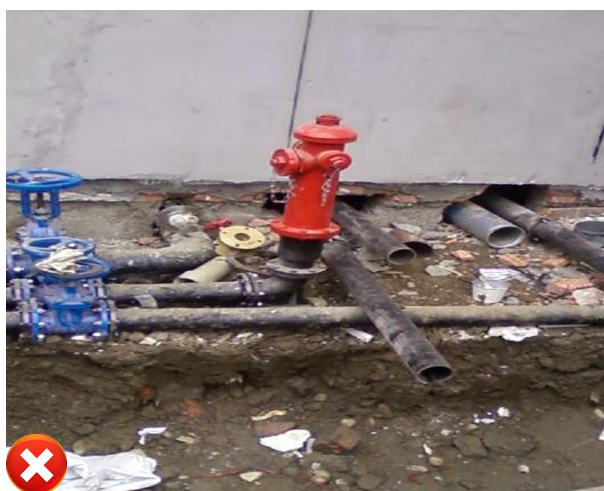
图 5.4.1-5 管网标高混乱、各管线交叉冲突
