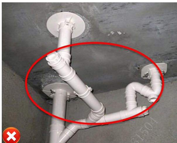
图 4.5.1 PVC 排水管支吊架设置不足
