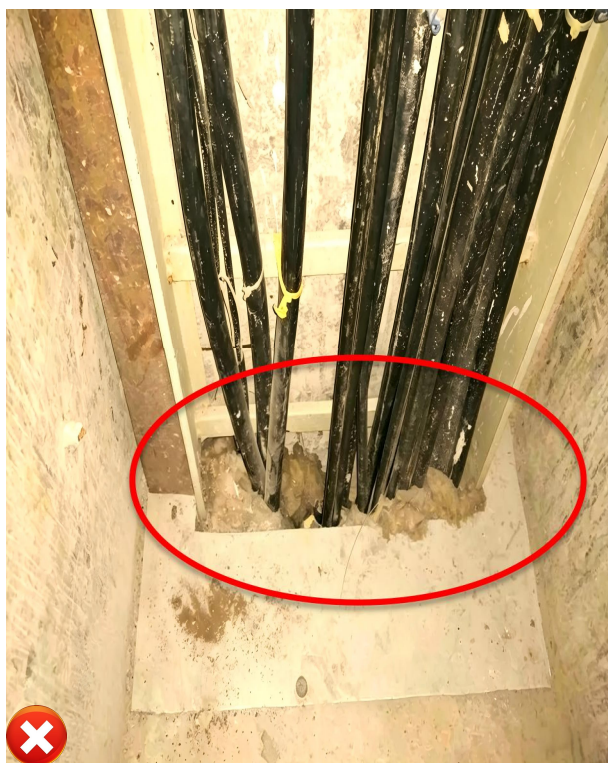
图 4.2.1 未采用专用防火材料封堵
