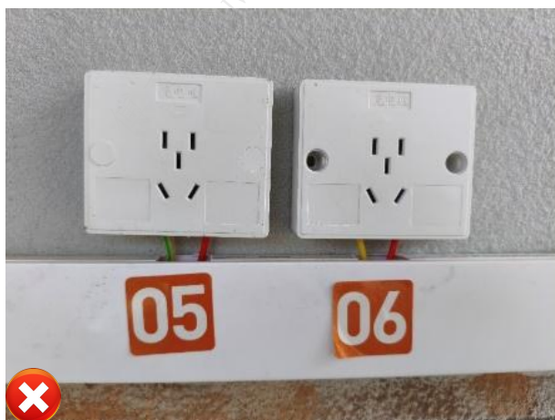
图 6.6.1-2 明敷的配电线路未采用金属线槽
