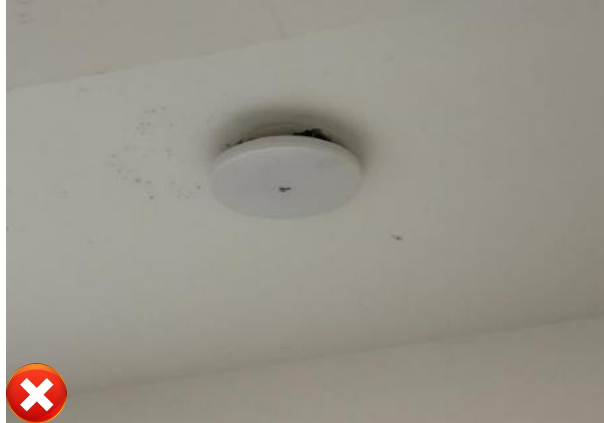
图 6.9.1 吸顶灯具安装不牢固
