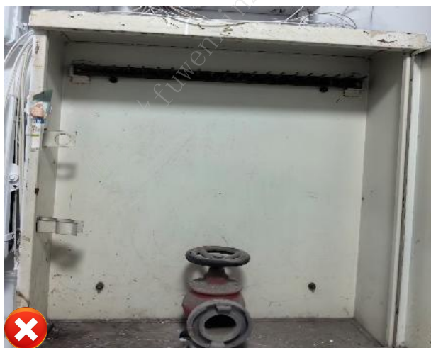
图 5.3.1-2 消火栓箱水带、水枪配置缺失
