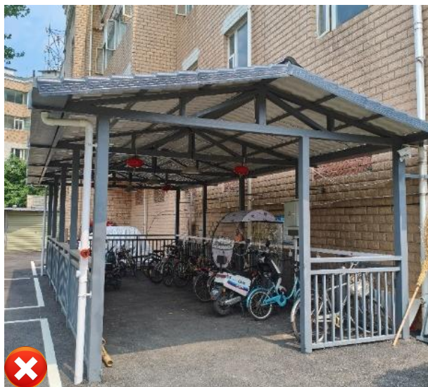
图 6.12.1 钢结构车棚钢构件未接地
