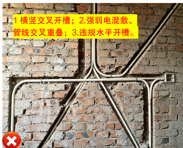
图 4.6.1 管线暗埋施工不规范
