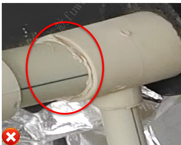
图 5.1.1-2 PPR 管道熔接局部熔瘤、熔接圈凸凹不匀
