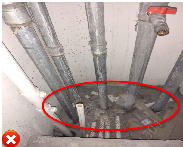
图 4.3.1 管道穿楼板未加设套管
