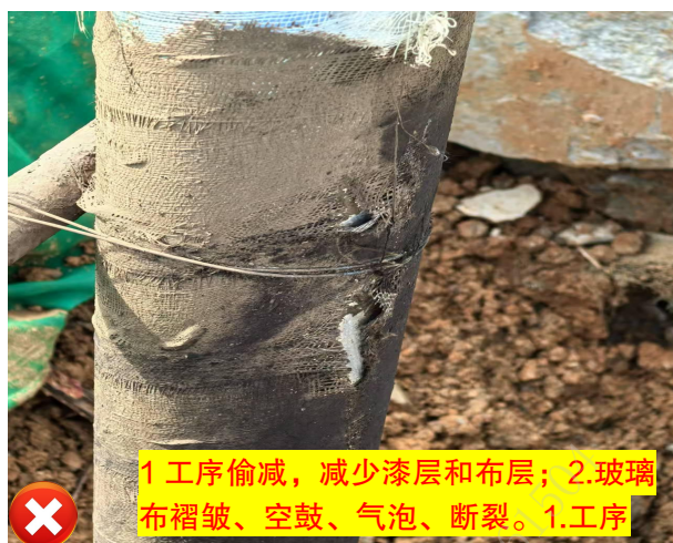
图 4.4.1 防腐施工不规范
