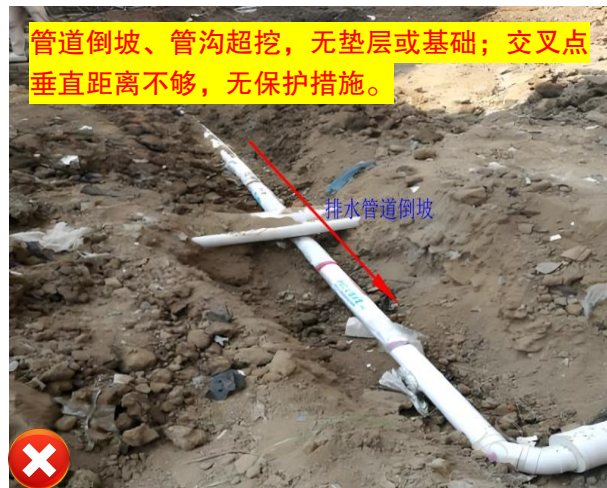
图 5.2.1-1 排水管道倒坡、管沟超挖、沟底不平整
