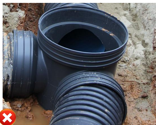
图 5.5.1-1 管道与井中心轴线不平直， 插入深度不足
