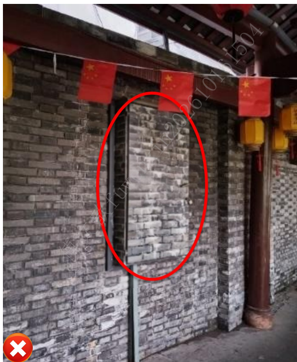
图 6.4.1-2 配电箱无防触电标识
