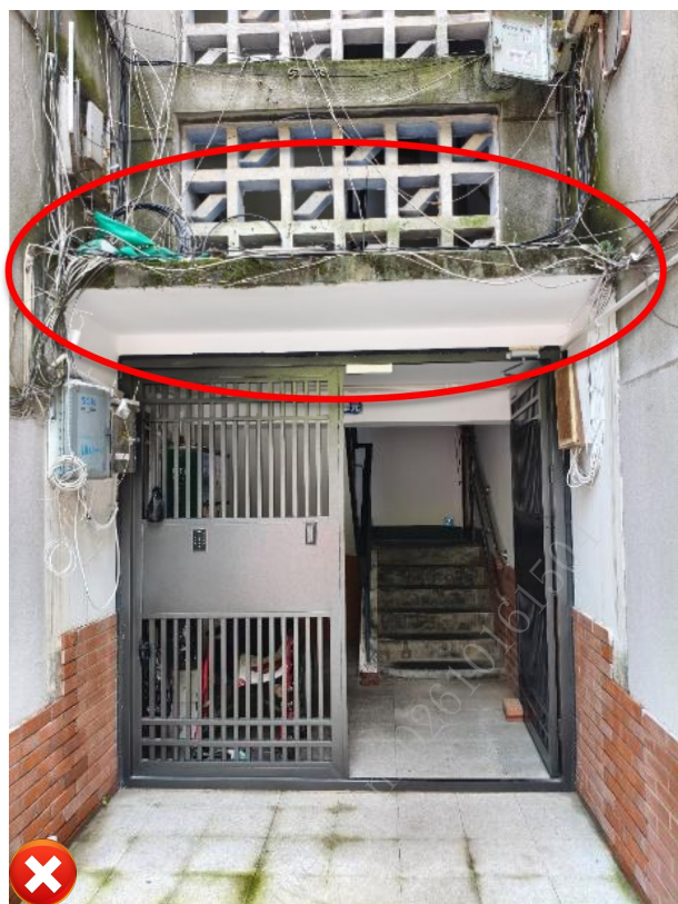
图 6.3.1 楼梯间线缆裸线、飞线
