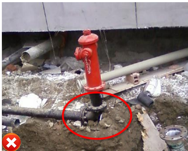
图 5.3.1-3 室外消火栓弯管底部未设置混凝土支墩或支座
