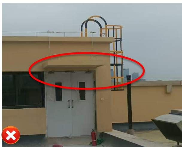
图 5.2.1-3 上人屋面通气管未高出门、窗顶 600mm
