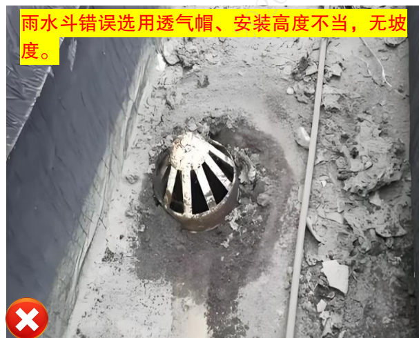
图 5.2.1-2 屋面雨水斗安装高度不当、四周无坡度
