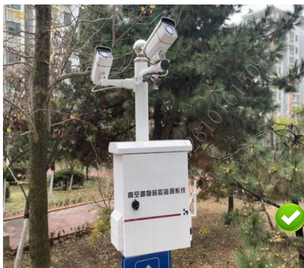
图 7.2.2-5 高空抛物摄像头安装
